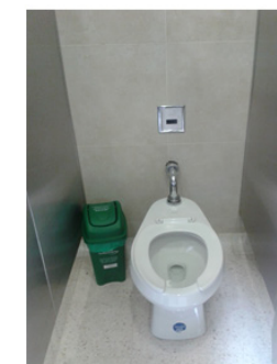
Sistemas de sensores en sanitarios
