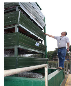
Sistema de aireación de CEF
