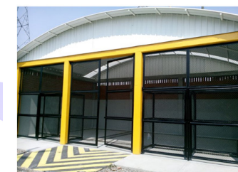
Ilustración 1 Bodega para almacenamiento temporal de residuos peligrosos en zona
